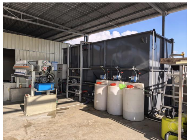
生产废水处理站实景图
