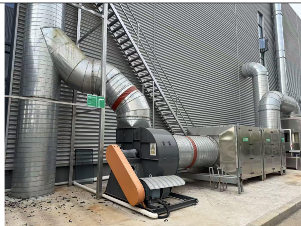
喷胶废气治理设施
