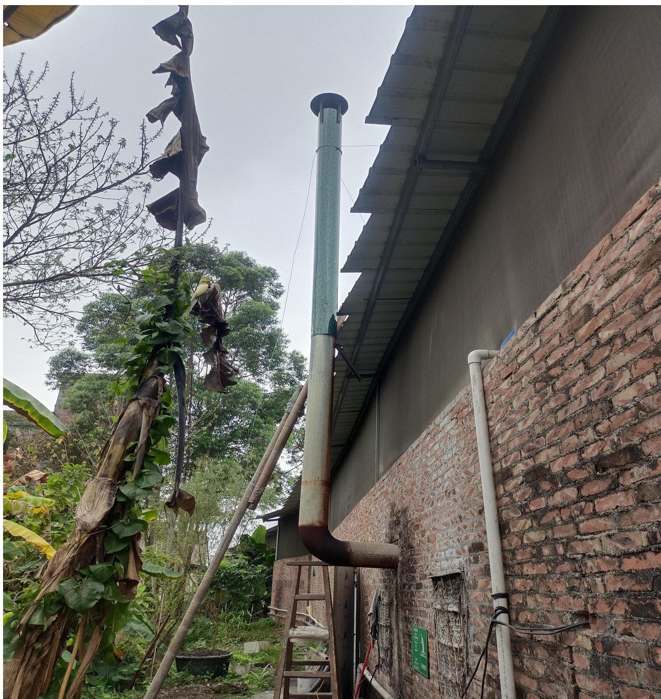
附图 4 环保治理设施照片
