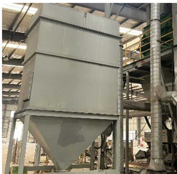
DA002 废气治理设施照片（脉冲布袋除尘器）
