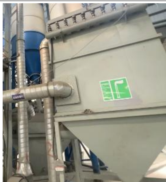
DA001 废气治理设施照片（脉冲布袋除尘器）
