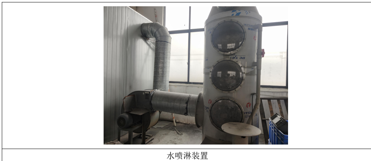
水喷淋装置 图 4-1 废气治理设施
